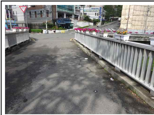
교면포장 S1 아스콘 망상균열 (A=1.0x5.0)
