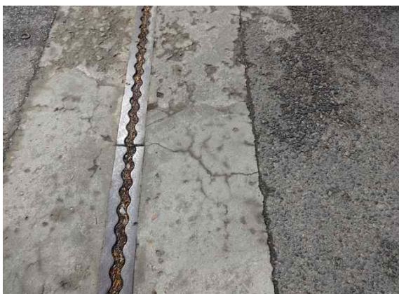
신축이음 A1 후타재 균열 (CW=0.2)
