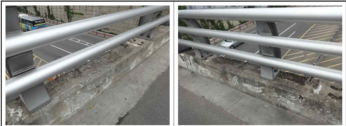
연석 S1 균열(CW=0.2)
