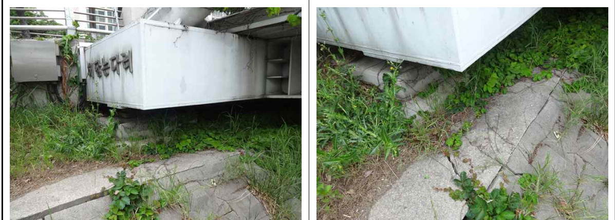
교대 A2 법면 파손 (A=5.0x0.5)
