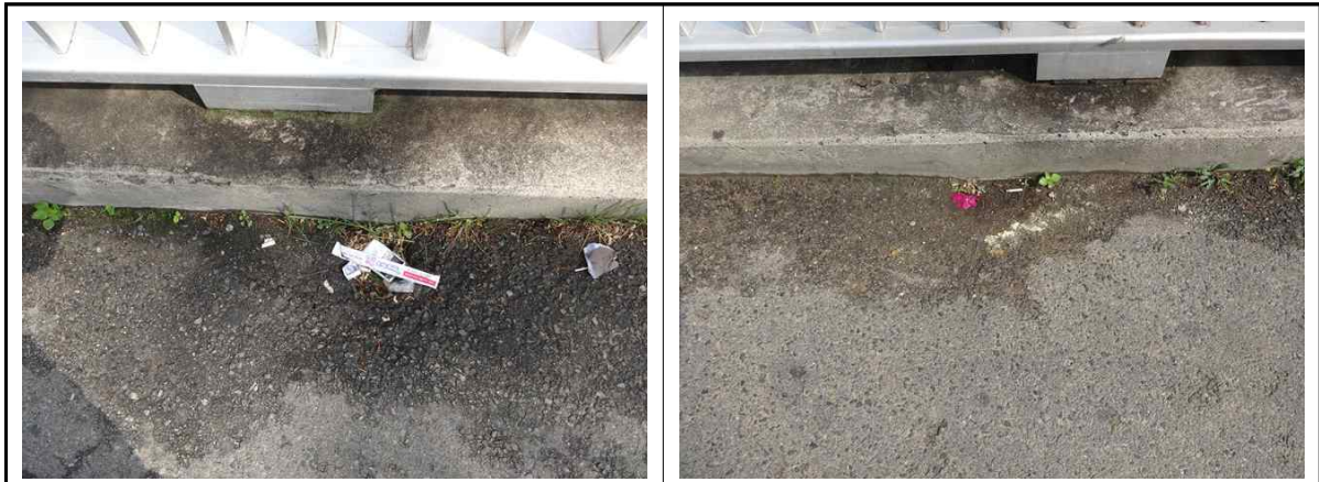
배수시설 S1 배수구 막힘 3개소
